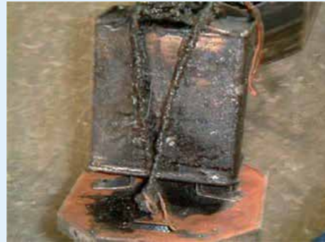
劣化が進行したコンデンサの例
