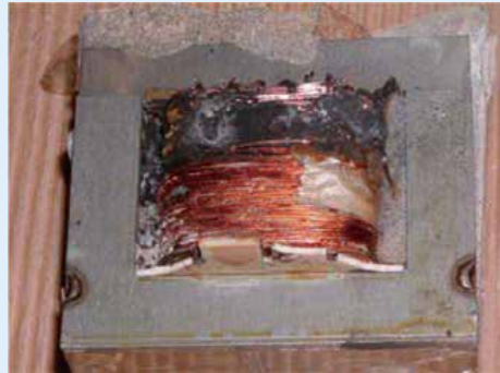
劣化が進行した安定器巻線の例
